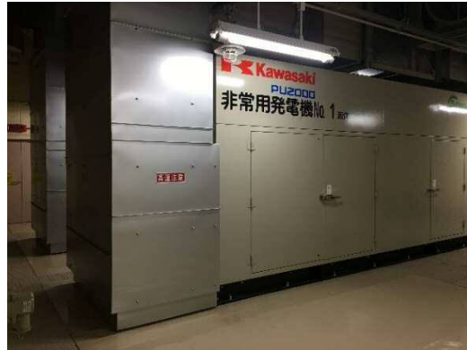
非常用発電機
