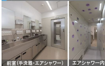
前室(手洗器・エアシャワー) エアシャワー内
