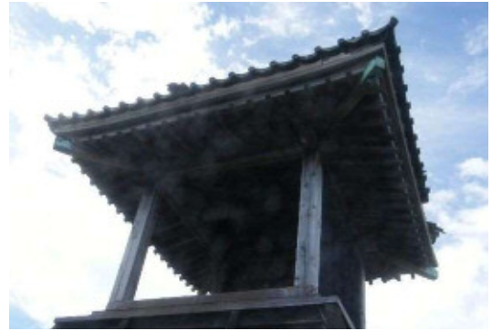
【前芝の燈明台の被災状況】
