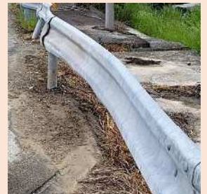
ガードレール等の破損
