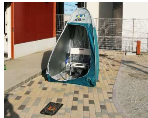
指定避難所に整備されたマンホールトイレ
